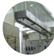
LV/MV DC busbars
